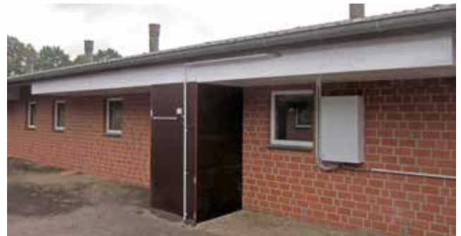
Stall Saerbeck: Zuluft über Erdwärmetauscher
