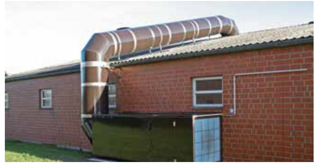
Stall Lütkebauer: Zuluft über das Dach
