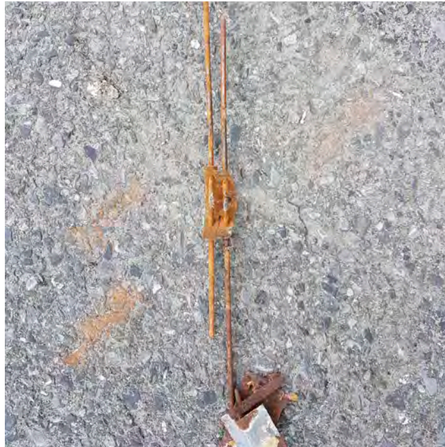
Die verzinkten Drahtabhängiger haben durch Kontakt mit der Stallluft Rost angesetzt. Foto: Raming
