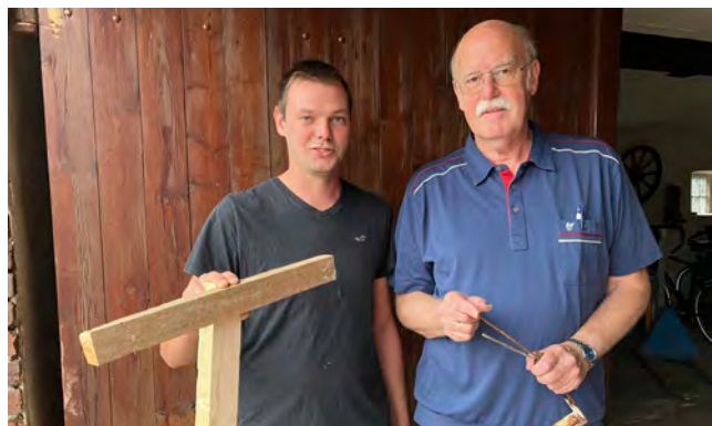
Raphael Närmann hat die Isolierplatten jetzt mit einem Dachlattengerüst abgehängt. Ringberater Josef Raming zeigt die angerosteten Drahtabhängiger.
