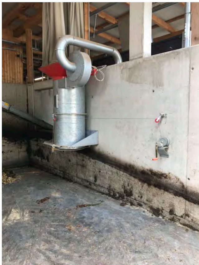
Foto 3: Eine Entstaubungsanlage für die Strohdusche
