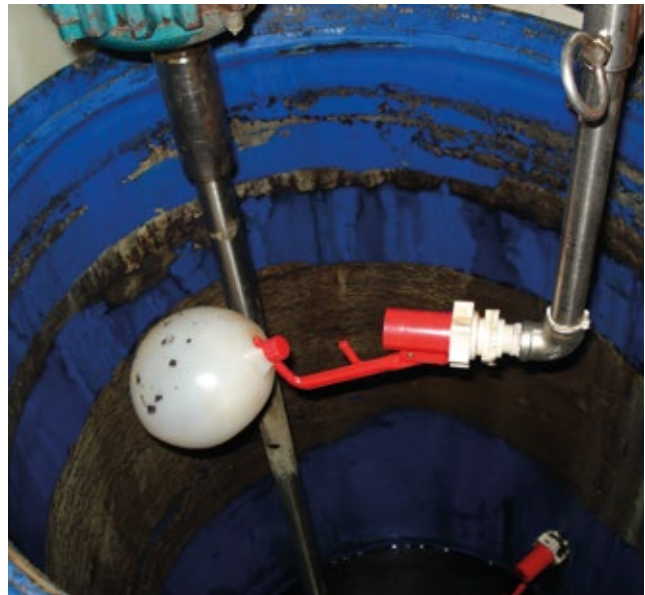
Abbildung 5: Im Anmischbottich sollten keine Ablagerungen wie auf dem Bild vorzufinden sein. Deshalb ist der Anmischbottich zu jedem Zeitpunkt unbedingt sauber zu halten (Quelle: Pia Münster).
