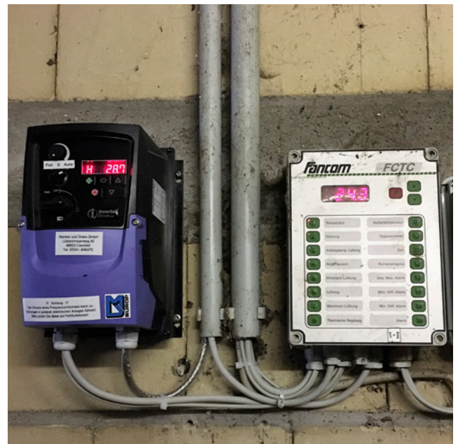
Mit einer Einzelmaßnahme wurde die Lüftungssteuerung durch einen Frequenzumrichter modernisiert.
